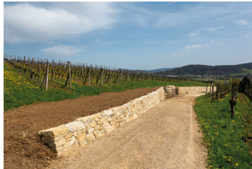
Fertig sanierte Alte Gasse Schinznach, Stützmauer berg- und talwärts Foto: Jurapark Aargau
